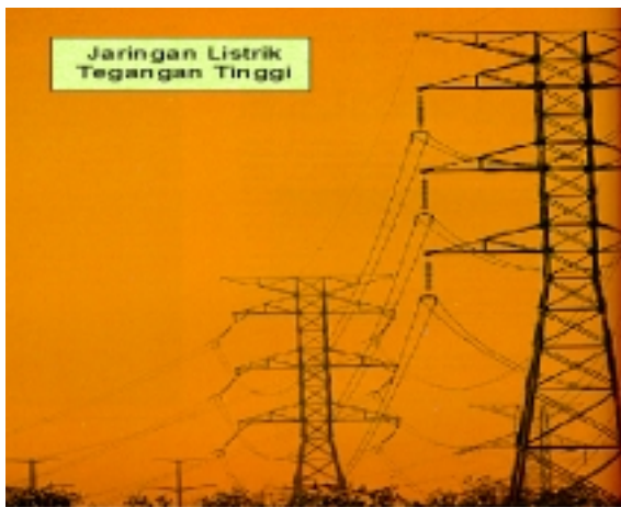
Gambar 4: Jaringan listrik tegangan tinggi
